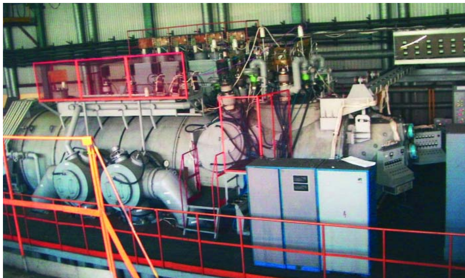
Установка для електронно-променевого переплаву титану на ДЗСЕМ Інституту електрозварювання ім. Є.О. Патона НАН України
