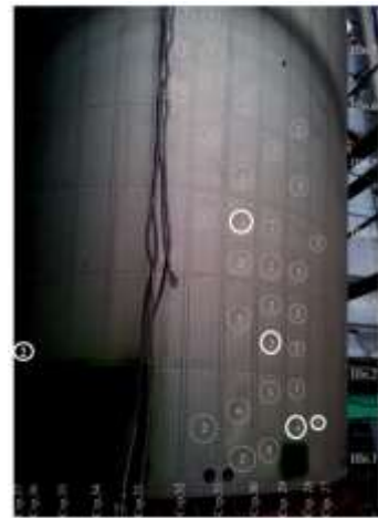
Рисунок 6 – Деформації обшивки корпусу міжступеневого відсіку у вигляді «хлопунів» між площинами II и III
