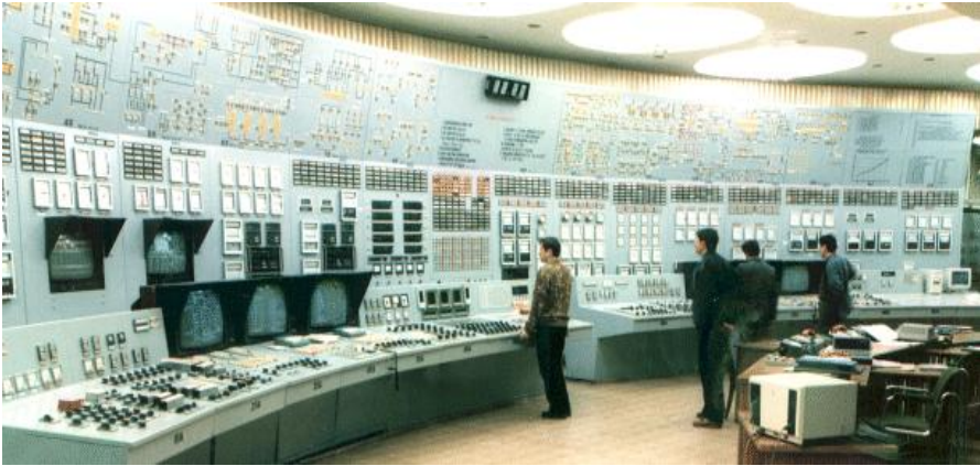
Рис. 8.1. Пулт керування енергоблоком Запорізької АЕС.
