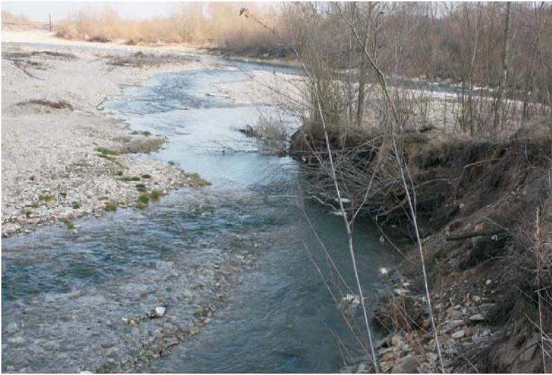
Рис. 4.14. Пригирлова ділянка русла Яблуньки з вираженою боковою ерозією правого берега та ознаками інтенсивного вертикального вривання русла, березень 2016 р.
