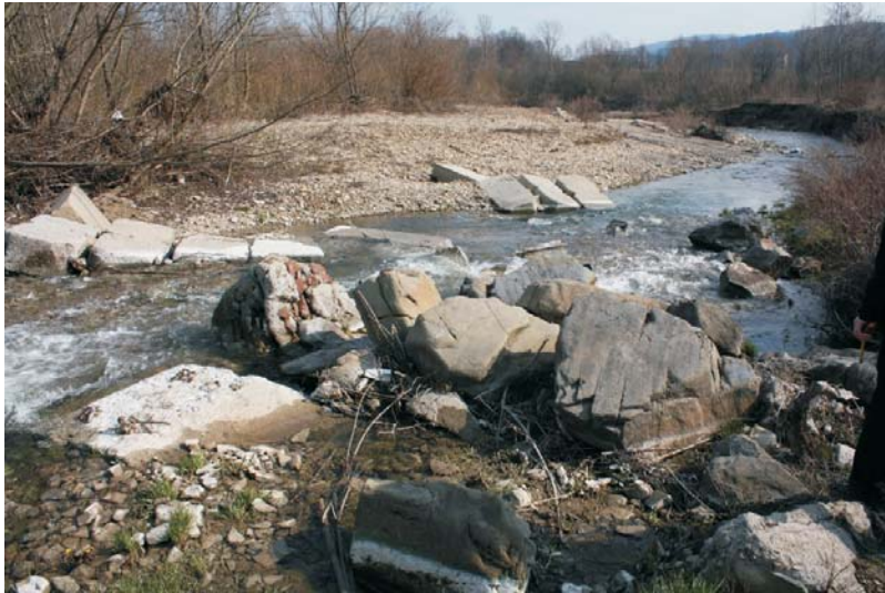
Рис. 4.12. Зруйновані габіонні конструкції в річищі Яблуньки, березень 2016 р.
