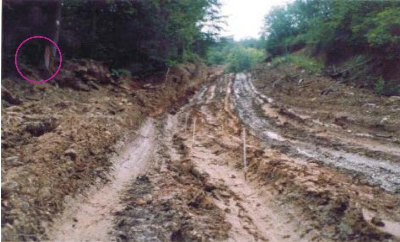
Рис. 4.20. Прокладений шлях для трелювання деревини з ділянки схилу після суцільної вирубки лісу (басейн потоку Красний), 16.07.2004
