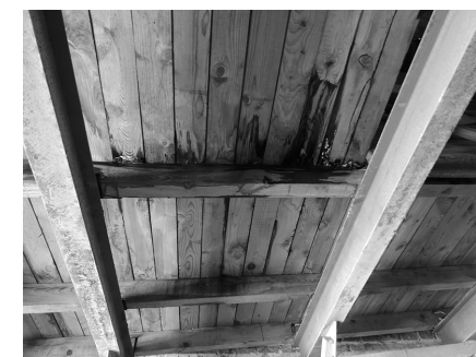
Іл. 6. Пошкодження дерев'яного обрешетування даху-навісу внаслідок систематичного затікання атмосферних опадів через руйнування покрівлі
