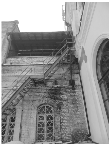
Іл. 4. Східний фасад Кухні Трапезної палати (Трапезна) – замокання фасаду внаслідок перезволоження атмосферними опадами через порушення в роботі зливовідвідної системи з покрівлі, влаштованої над відкритою терасою
