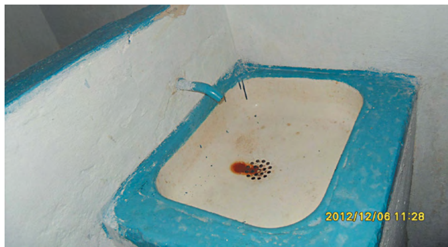
В ізоляторі тимчасового тримання Волноваського РВ ГУМВС України в Донецькій області немає водопровідного крана
