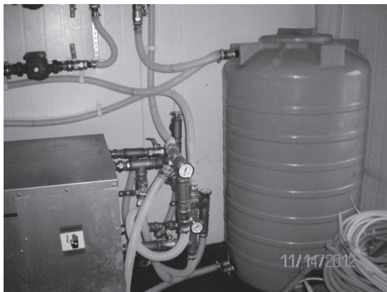
Рис. 3 – Бак-аккумулятор и водяной циркуляционный контур экспериментального блока термopодготовки УЗВ
