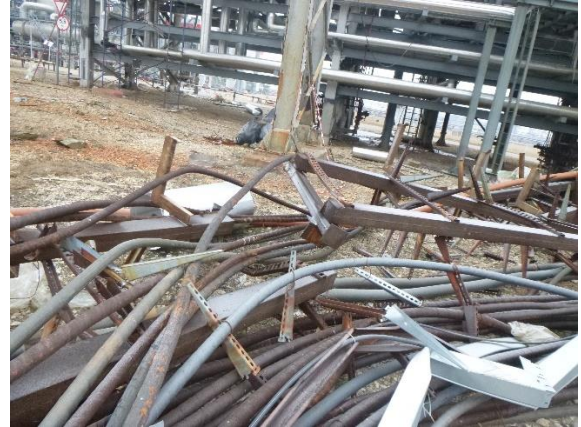
Рис. 2. Балки кабельной трассы между после обрушения изогнуты и деформированы
