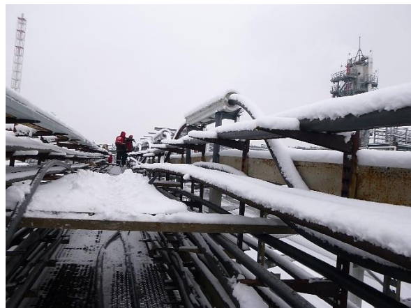
Рис. 4. Прогибы металлических балок кабельной трасы - 100мм (1/100 пролета).
