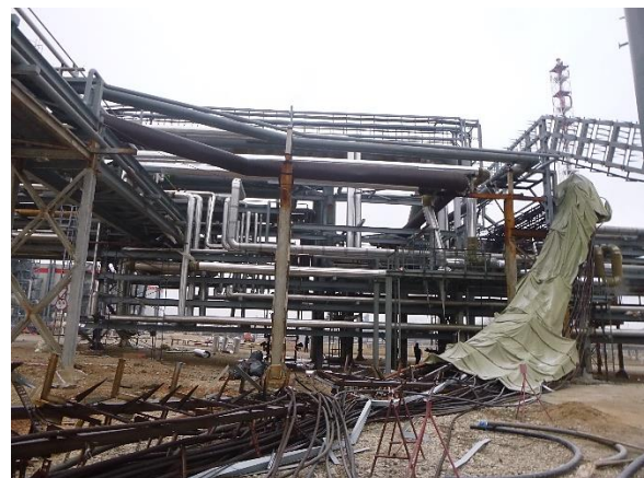
Рис.1. Общий вид металлической технологической эстакады после обрушения балок кабельной трассы.
