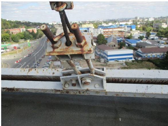
Рис. 4. Руйнування захисного лакофарбового покриття на балках та елементах кріплення відтяжок.
