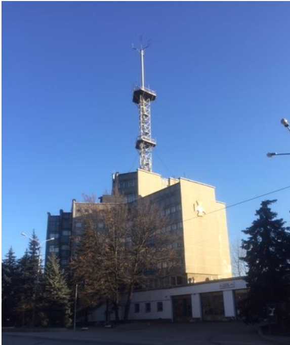
Рис. 1. Загальний вигляд металевої вежі зі щоглою на покрівлі будівлі ГУДС України з надзвичайних ситуацій у Харківській області.
