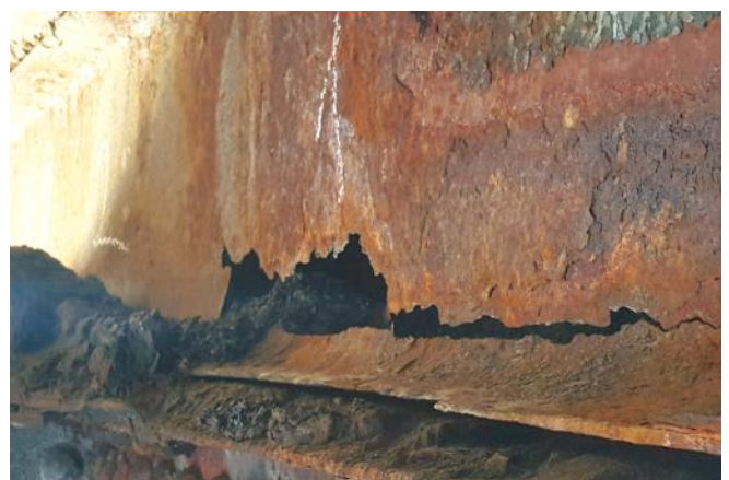
Рис. 4. Руйнування поперечної балки на опорі № 25
