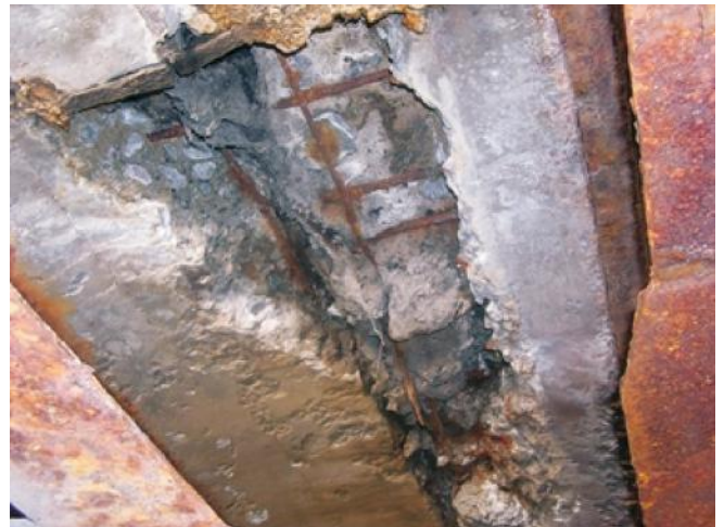
Рис. 8. Руйнування захисного шару бетону плити проїзної частини
