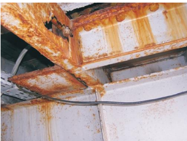
Рис. 9. Корозійне руйнування балкової клітки стовпа освітлення № 18
