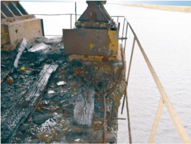
Рис. 5. Сколи бетону, оголення та корозія арматури підферменників опори № 11
