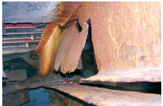
Рис. 3. Руйнування поперечної балки на опорі № 1
