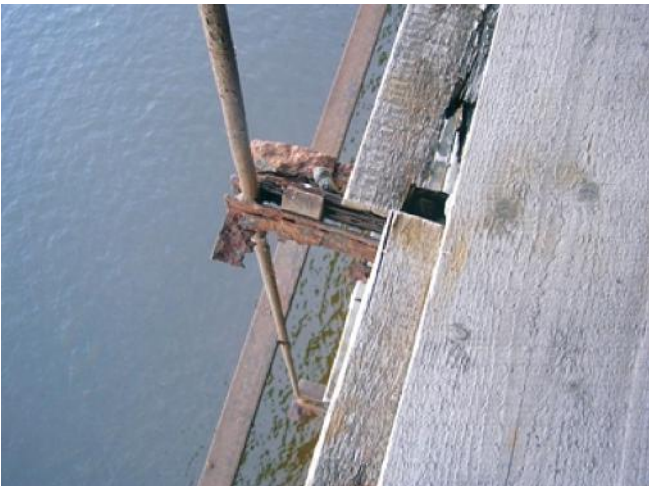
Рис. 7. Корозія металу несних елементів оглядових проходів
