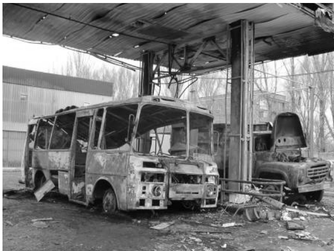
Рисунок. Повреждения в результате взрыва метановоздушной смеси автотранспортных средств и строительных конструкций на многотопливном автозаправочном комплексе
