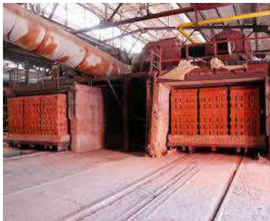
Рис. 7. Зовнішній вигляд тунельної печі
