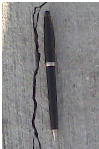
Рис. 2. Тріщина на поверхні бетонного покриття
