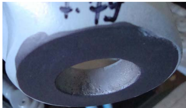
Рис. 6. Місце корозійного ураження вузла-п'ятки підкоса підредукторної рами після усунення корозії та антикорозійної обробки.
