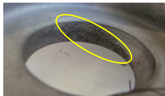
Рис. 4. Корозійні ураження на внутрішній поверхні отвору вузла-п’ятки підкоса підредукторної рами. Джерело: [6, с. 15].
