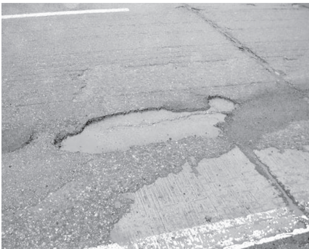
Рис. 3. Ухудшение ровности покрытия
