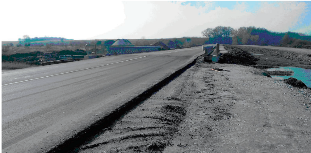
Рисунок 5 — Просідання дорожнього одягу перед мостом на км 56 + 717 автомобільної дороги М-22 Полтава – Олександрія, через р. Оленівка
