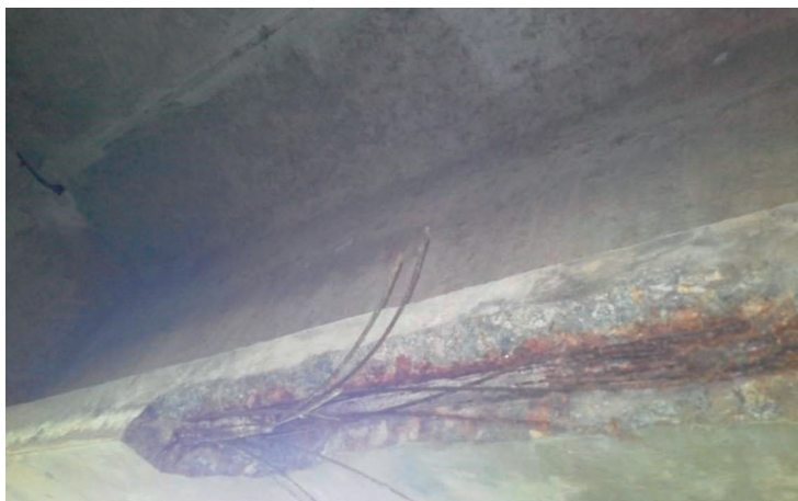
Рисунок 3 — Дефекти балок моста через р. Псел на км 50+840 автомобільної дороги Т-17-05 Лохвиця – Гадяч – Охтирка КПП «Велика Писарівка» до капітального ремонту
