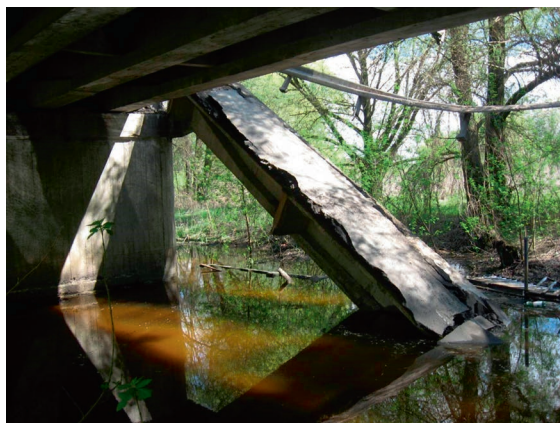
Рисунок 1 — Руйнування крайньої балки моста через р. Сула на км 172+598 автомобільної дороги Р-60 Кролевець – Конотоп – Ромни – Пирятин. Наразі відбувається капітальний ремонт моста у рамках програми «Велике будівництво»
