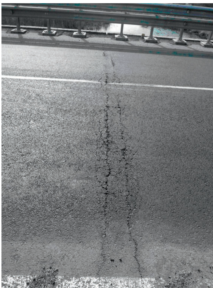
Рисунок 4 — Тріщина над деформаційним швом перед ремонтом моста на км 48+190 автомобільної дороги М-22 Полтава – Олександрія
