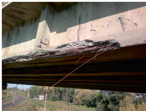
Рисунок 6 — Руйнування захисного шару, корозія й обрив струн попередньо напруженої робочої арматури (Шляхопровід через електрифіковану залізничну колію на автомобільній дорозі національного значення Н-01 Київ-Знам'янка на км 164+068)
