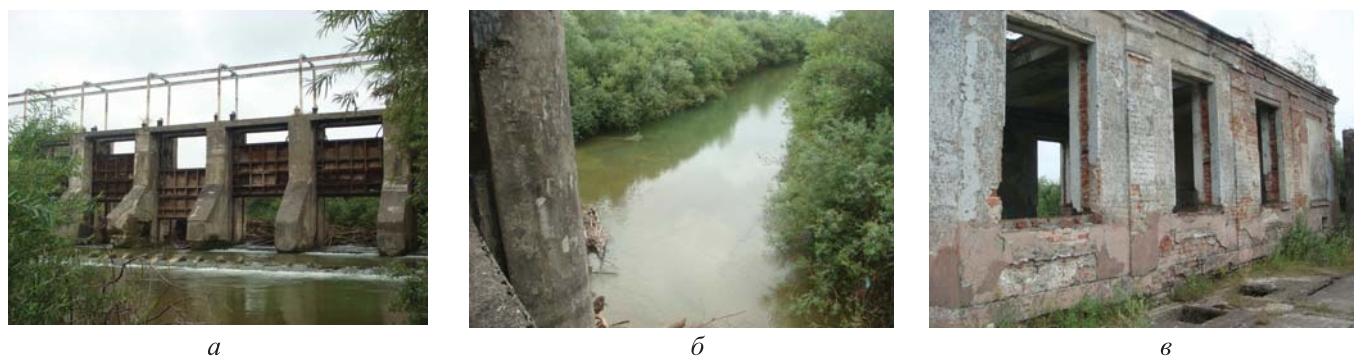
Рис. 2. Стан гідроспоруд Новошицької МГЕС (р. Бистриця Тисменицька, Львівська обл.) до відновлення: а) вид на греблю з нижнього б'єфа; б) стан русла ріки у верхньому б'єфі; в) стан будівлі МГЕС
