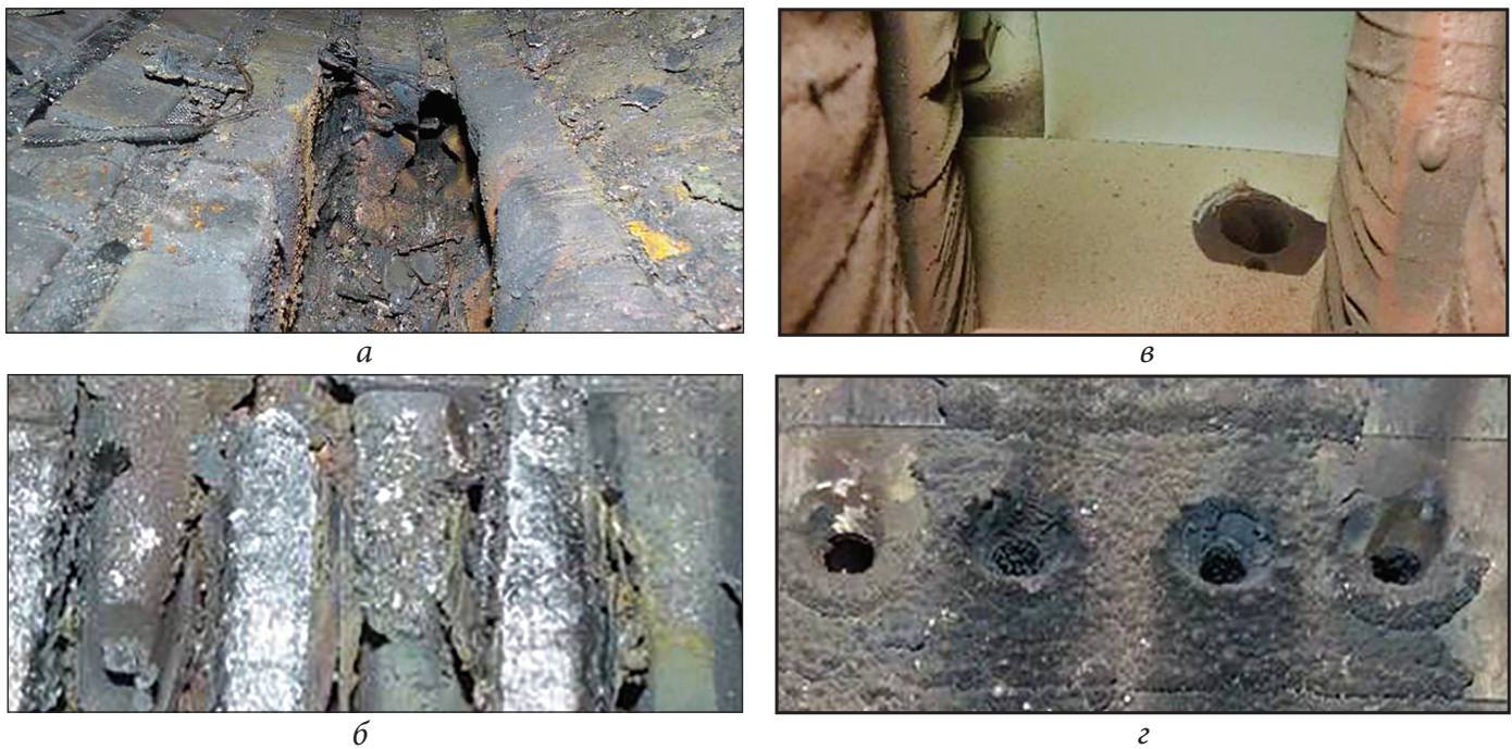
Рис. 3. Зафіксовані пошкодження: а та б – пошкодження паза статора електродвигуна; в – відсутність болта кріплення статора; г – пошкодження елементів ротора
