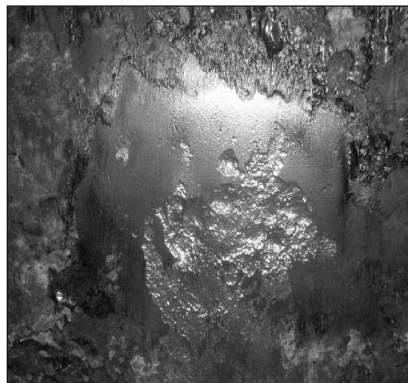
Рисунок 2 – Локалізоване корозійне ураження магістрального газопроводу „Сфремівка – Диканька – Київ” [6]
