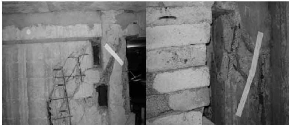
Рис. 1. Разрушение диафрагмы жесткости и колонны в подвале.
