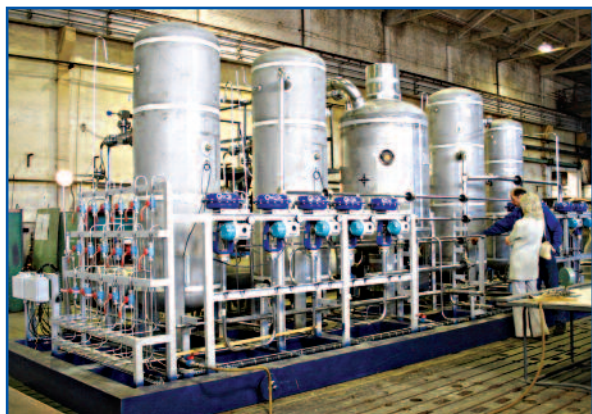
Фото 2. Внешний вид блока ожижения УСПГ-2,5 без изоляции
