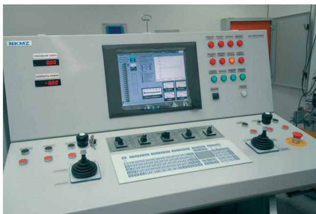
Рис. 1. Пульт управления подъемной машиной.
