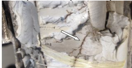
Рис. 1 – Следы электрических разрядов
