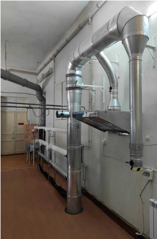
Рис. 3. Загальний вид стенду для проведення досліджень
