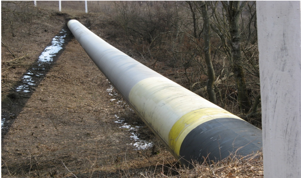
Рис. 1. Повітряний перехід МГ Острогозьк-Шебелинка 165-км
