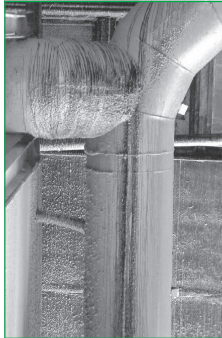
Рис. 4. Шар цукру на повітропроводі.
