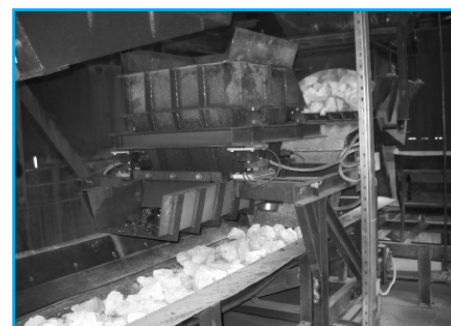
Станция подготовки шихты
