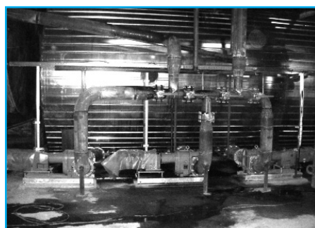
Приемная мешалка маточного утфеля
