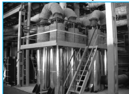
Подогреватели дефекованого сока
