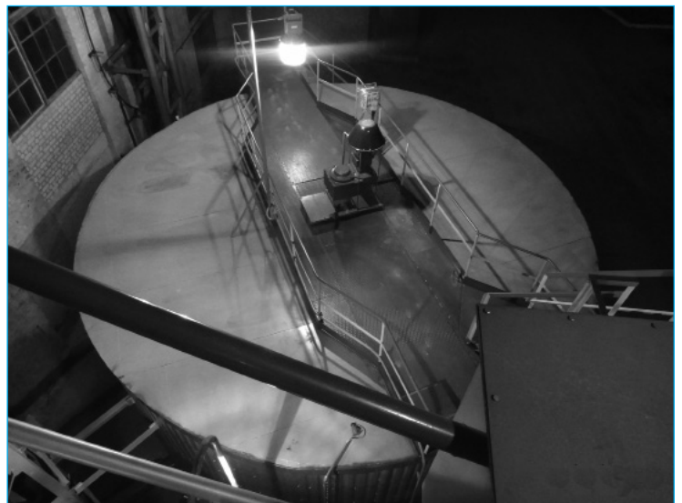
Холодний дефекатор з приводом (вид зверху)
