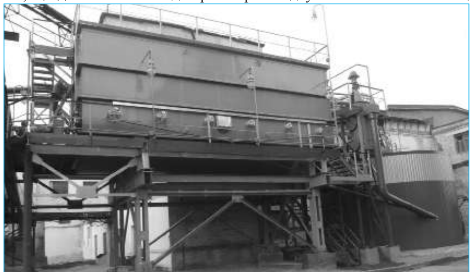
Фото 1. Обладнання реконструйованої ділянки станції
