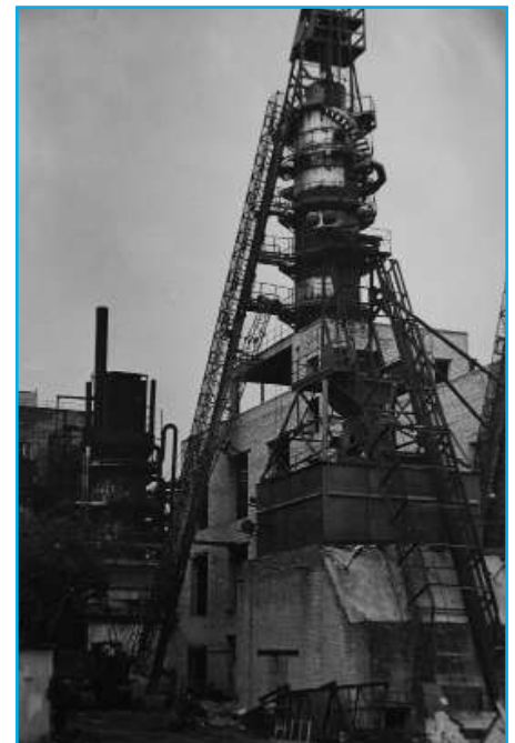
Газова піч на мазуті (Яготинський цукровий завод)
