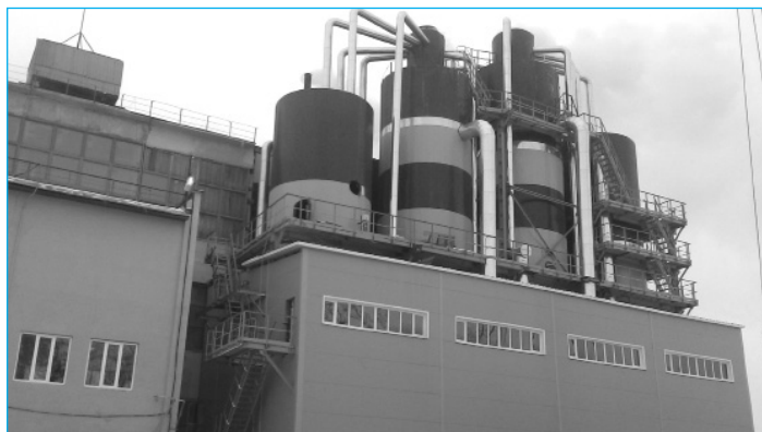
Станція очищення соку продуктивністю 10000 тонн буряків на добу, 2016 рік, Єлецький цукровий завод
