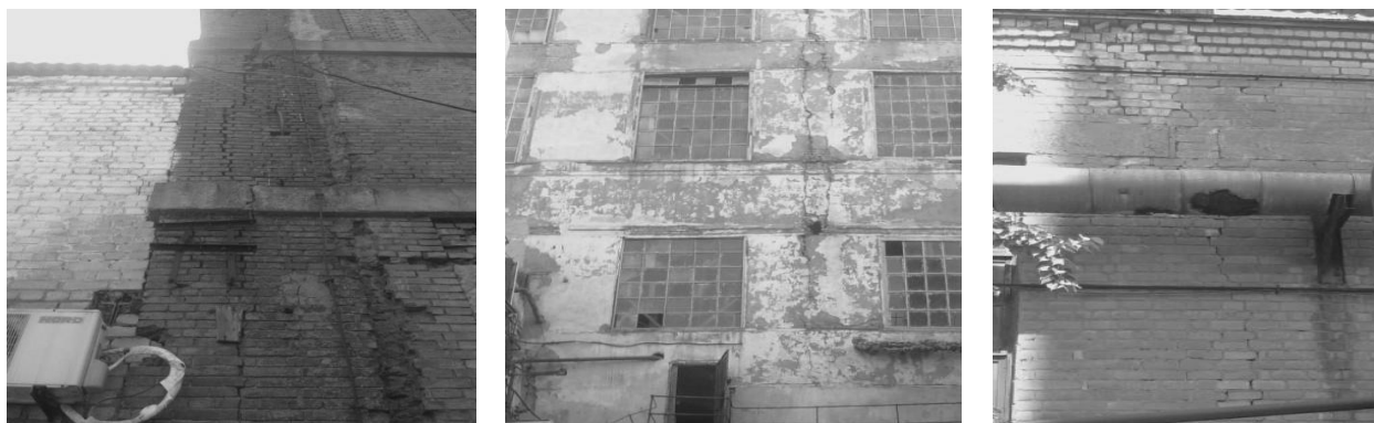
Рис. 3. Фотоматеріал про наявність рушення фундаменту та конструкцій споруди
