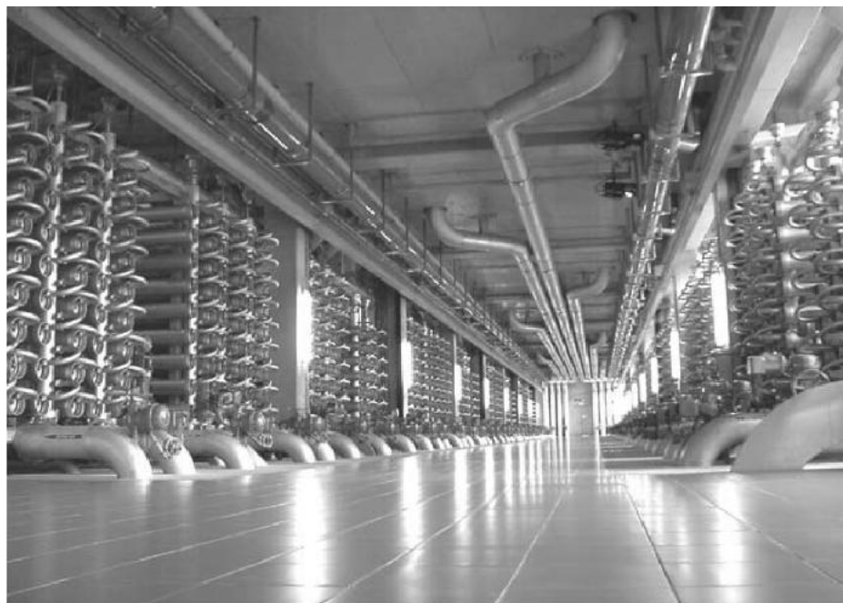
Рис. 5. НФ-установка питьевой воды в Meru-Sur-Oise [6]
