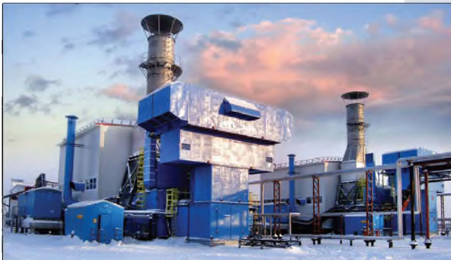
Рис. 1. Общий вид газотурбинной электростанции
