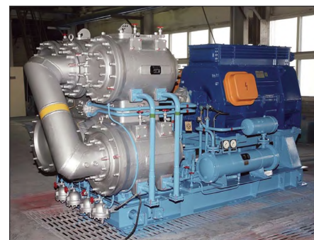
Рис. 3. Центробежная компрессорная установка АЭРОКОМ 43-125/10,2 для обеспечения воздухом КИП на ОАО «ТАНЕКО» (г. Нижнекамск). Привод – электродвигатель мощностью 1000 кВт
