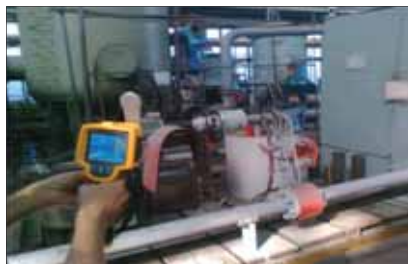
Рис. 5. Измерение с помощью тепловизора тепловых полей нового насосного агрегата АЦНА 300-120 (Ленинградская АЭС-2) на испытательном стенде
