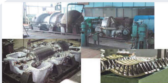
Рис. 1. Общий вид газотурбинной установки ГТТ-3
