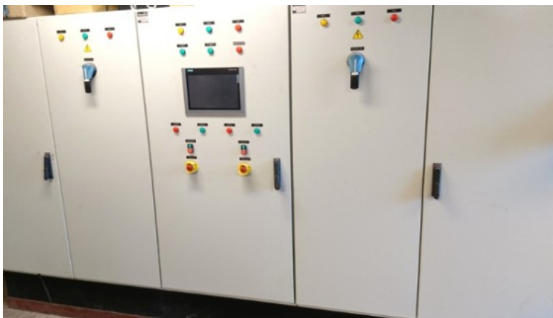
Рис. 2. Щкаф ПЛК системы КИПуА нагнетателей.
