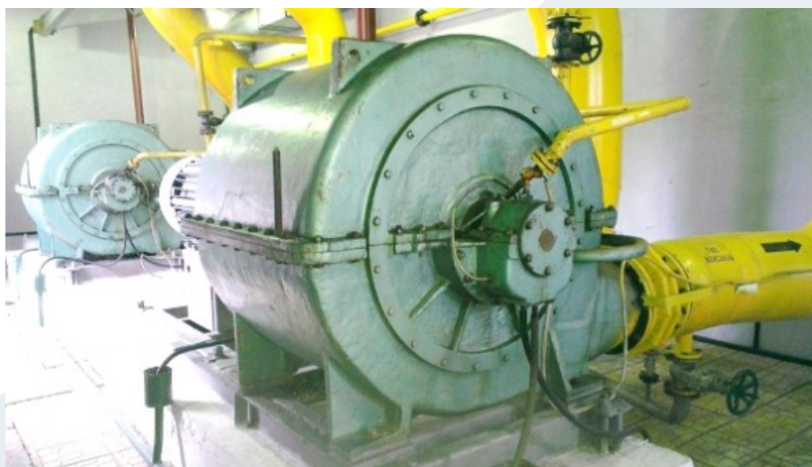
Рис. 3. Газодувки коксового газа ГЦ-300/1,2У2 на газоповысительной станции Макеевского металлургического комбината.
