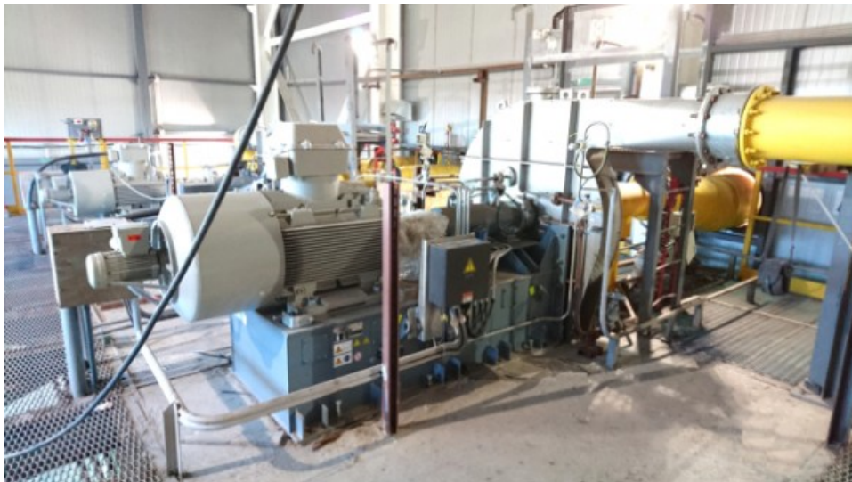
Рис. 1. Установки компрессорные газовые центробежные ГЦ-270/1,18 У2 и ГЦ-170/1,18 У2 в составе «газоповысительной станции коксового газа».
