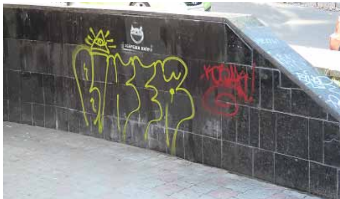
Рисунок 4. Приклад невдалого видалення тегу з поверхні облицювання, виконаного з покостівського граніту (Київ). Розчинення фарби призвело до перефарбування поверхні виробу в жовтий колір
