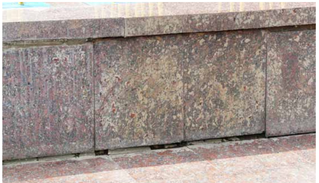
Рисунок 2. Комплексні пошкодження гранітного облицювання басейну (Чернігів): висоли, виділення іржі, селективне руйнування мінеральних компонентів, знебарвлення
