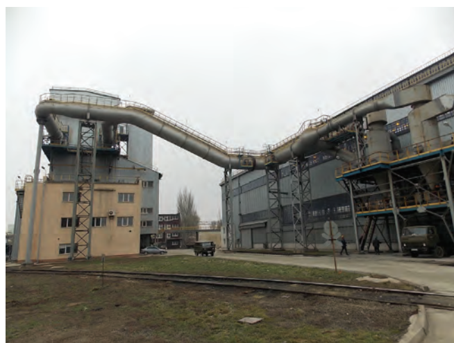
Рис. 5. Газоочистка ДСК-6 в ПАО «НЗФ»
