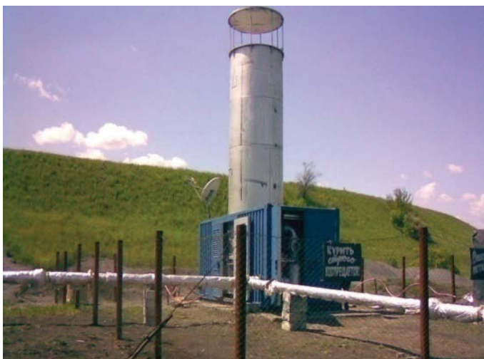
Рис. 3. Внешний вид контейнерной газопользовательной установки
