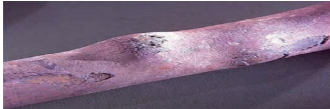
Рис. 2. Разрушение котельной трубы вследствие локального перегрева
