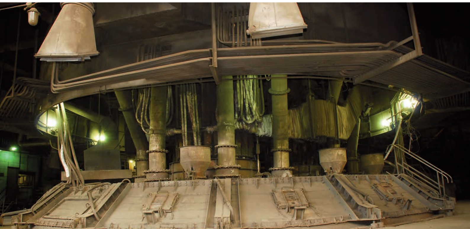
Ферросплавная руднотермическая электропечь РКГ-75
