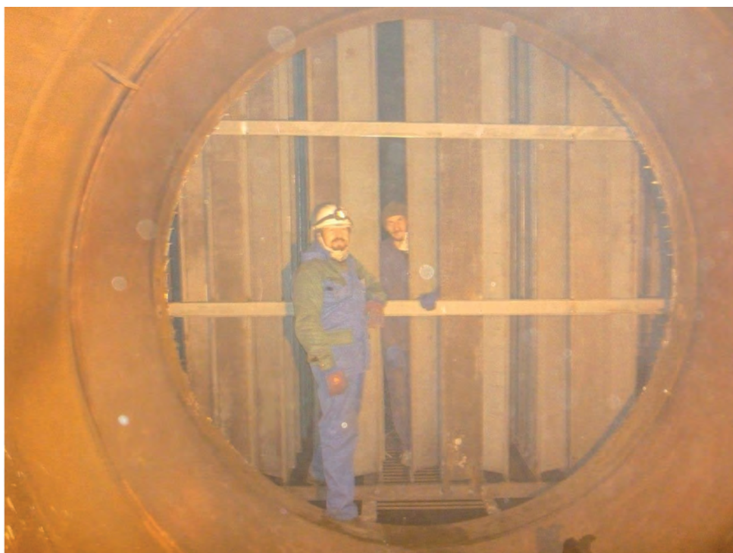
Рис. 2. Аппарат инерционного осаждения «VAV-250-АФК». Газовый коллектор агломашины № 12 ПАО «ДМК» (декабрь 2015 г.)
