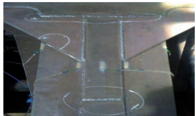
Тріщина в хребтовій та шворневій балках довгобазного вагона-платформи
