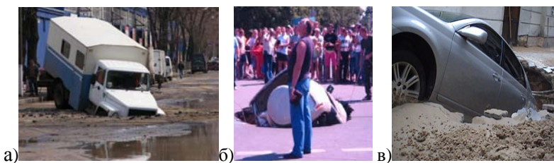
Рис. 3. Розмиття основ доріг, що пов'язані з аваріями мереж водопостачання та водовідведення: а) м. Харків (04.2009 р.), б) м.Одеса (08.2009 р.), в) м. Київ (10.2006 р.)
