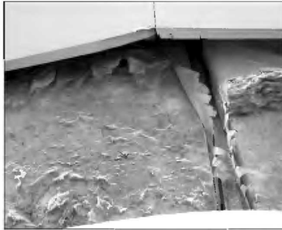
Рис.1. Разрушение слоя утеплителя из-за отсутствия влагоудаления [4].
