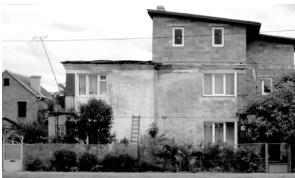
Самовільна добудова частини житлового будинку проекту М. Д. Вендзиловича по вул. Кн.Ольги.
