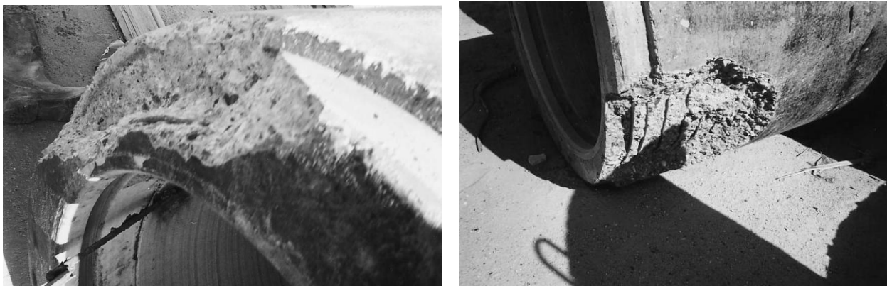
Рис.3. Фотографії руйнування торцевої частини обробки у вигляді відколу, зафіксовані при вході обробки в першу криволінійну ділянку.
